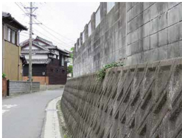
民放でも報道された仲原保育所西側のブロック塀
