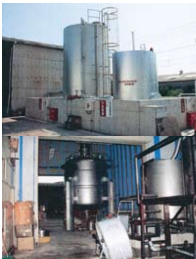
廃油リサイクルシステム
